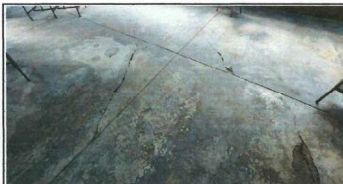
Foto 4: se necesita la sustitucion de piso de concreto
